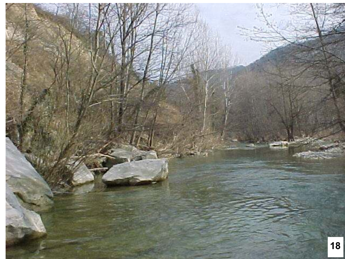
FOTO 13-18: Piede del muro e alveo del fiume Lamone
